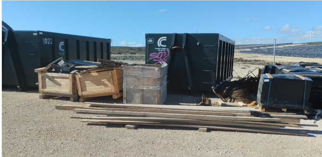
Punto limpio de RNP: cierto desorden entre materiales y residuos. Falta reponer el contenedor de madera
