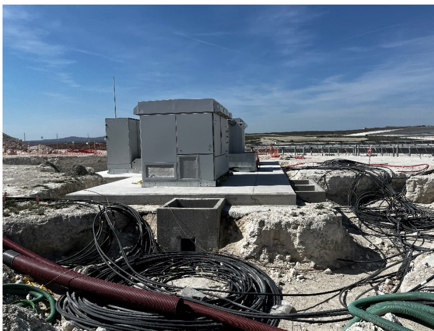
Figura 2 Cableado de los CT
