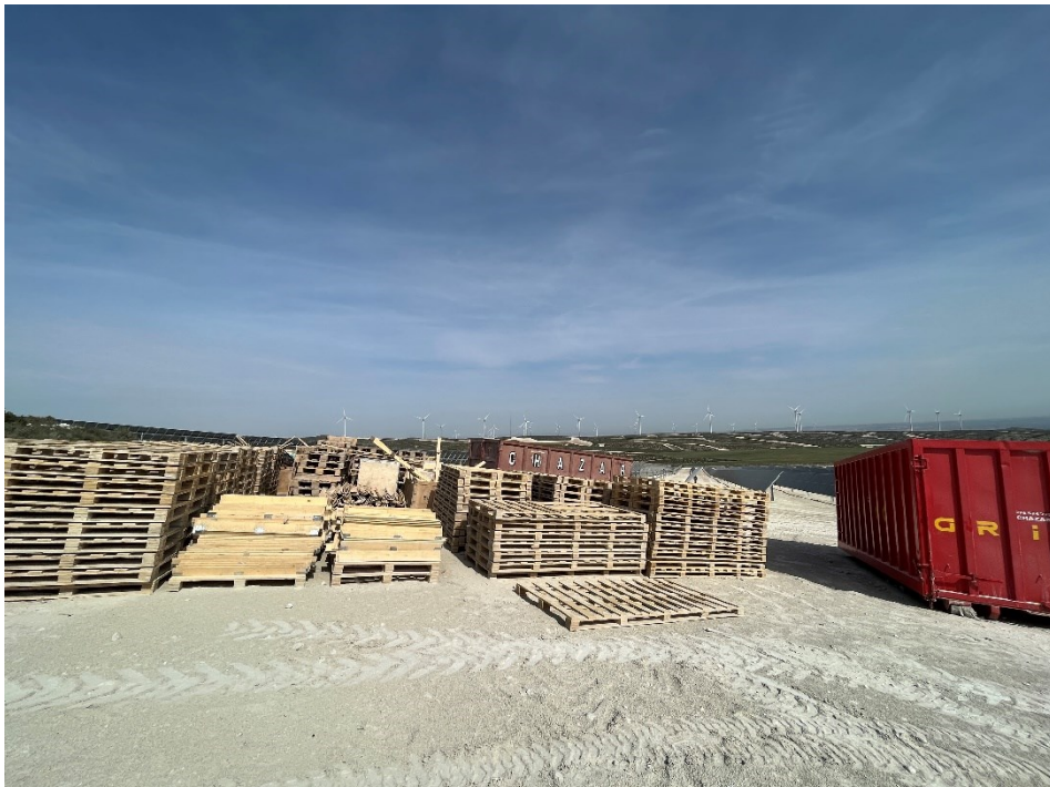
Figura 10 Acopio temporal y punto limpio de RNP dispuesto dentro de la planta
