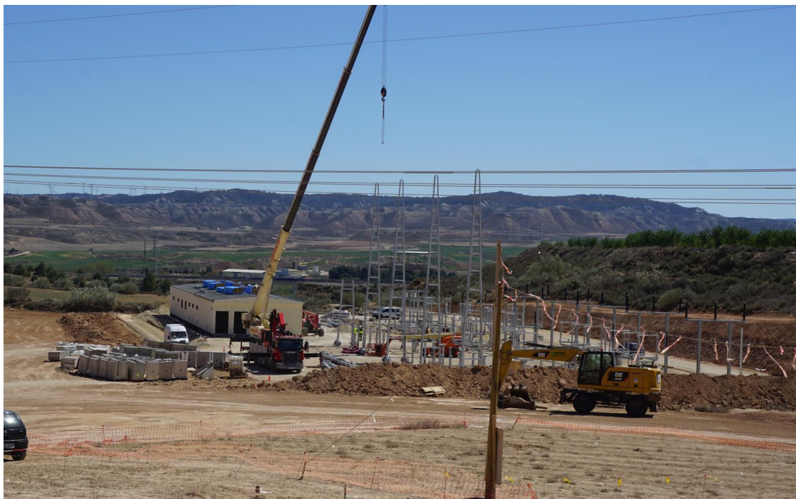
Figura 2b Situación de la subestación eléctrica Vallobar, primera quincena de abril
