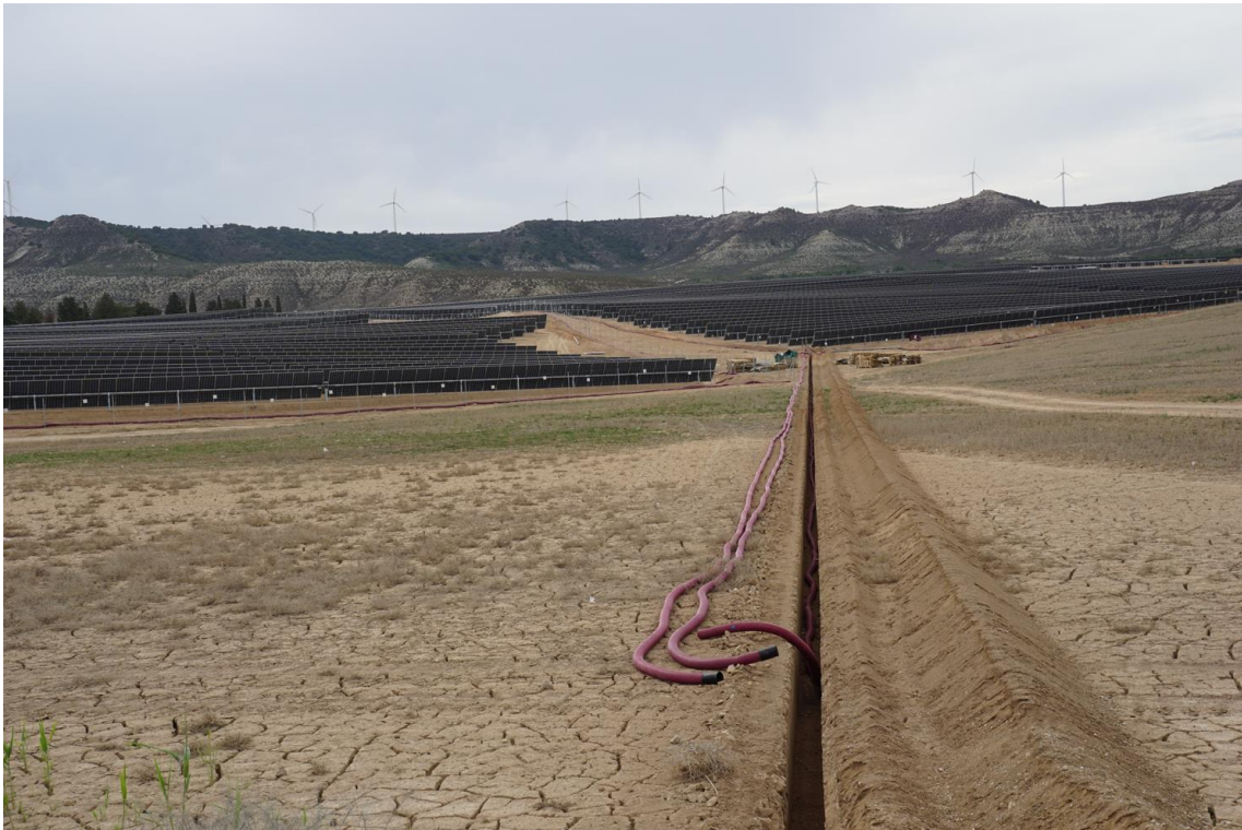
Figura 5 Despliegue de red eléctrica hacia zona Este de Vallobar
