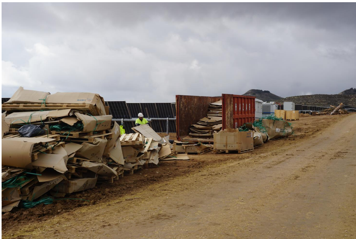
Figura 3 Separación de residuos
