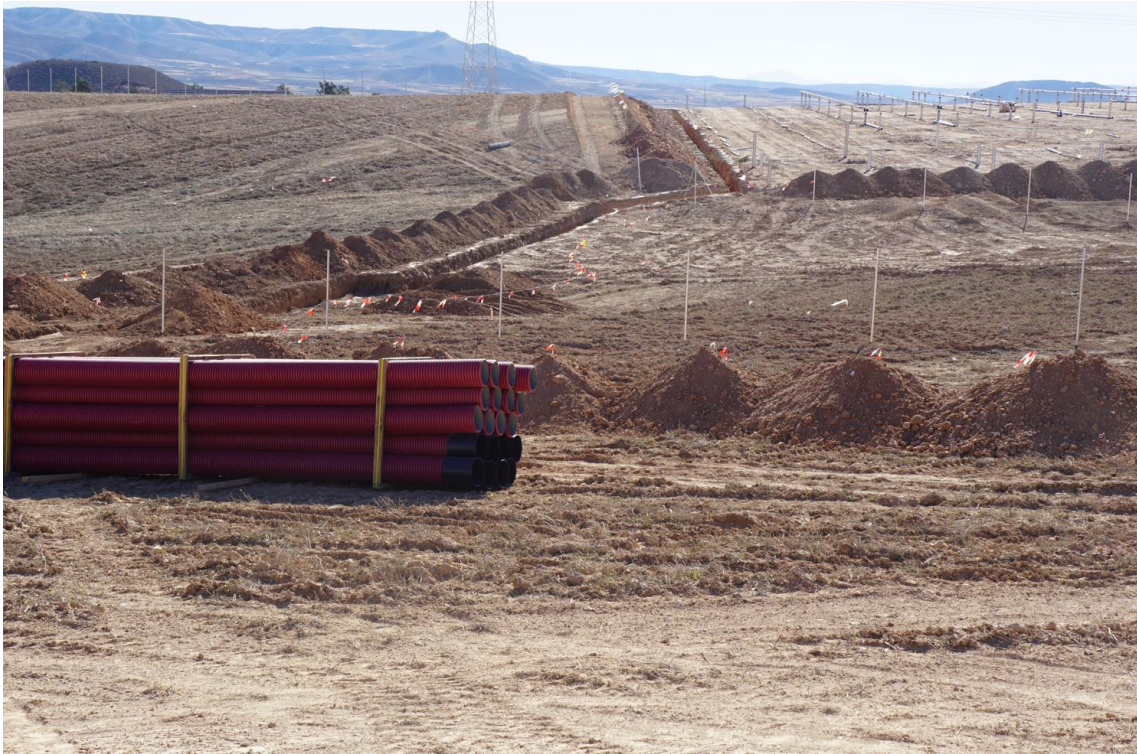
Figura 6 Despliegue de conexiones eléctricas soterradas
