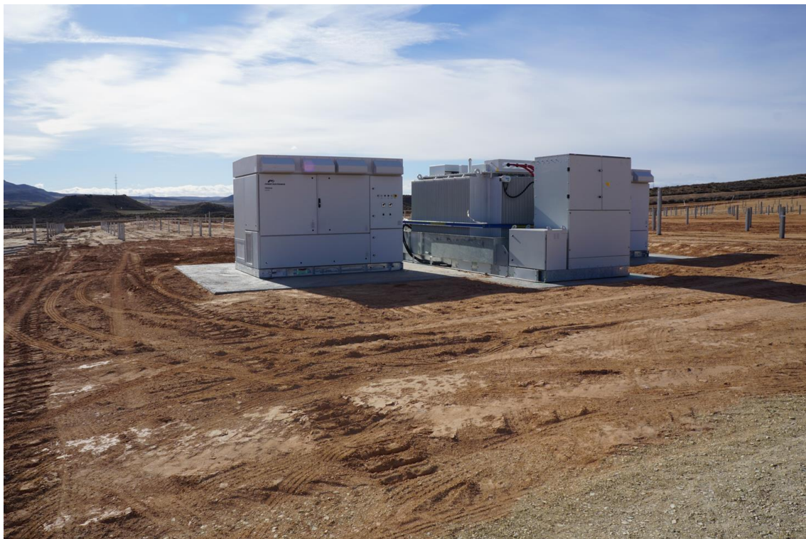
Figura 8 Estación de transformación eléctrica
