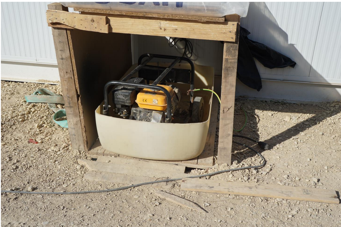
Figura 10 Generador instalado sobre cubeta de contención
