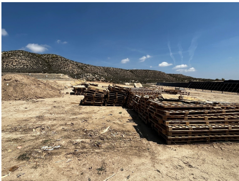
Figura 9 Acopio temporal de residuos no peligrosos
