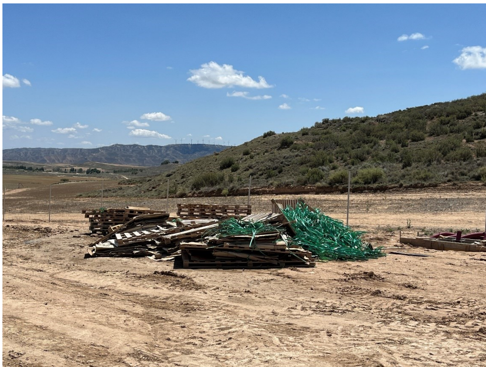
Figura 8 Acopio temporal de residuos no peligrosos
