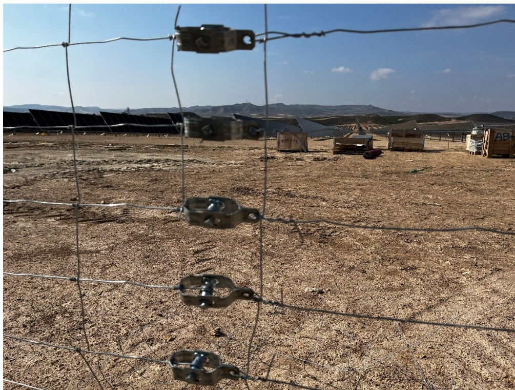
Figura 10 Elementos punzantes en el vallado perimetral
