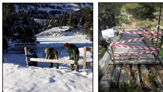
Imágenes de trabajos en infraestructuras de UP. Desmontaje del vallado de La Besurta y señalización del cierre temporal de un puente en Sahún por peligro para los visitantes.
