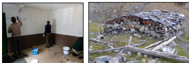
Limpieza y pintado del refugio de Tabernes, trabajos de reparación de la cabaña de pastores de Aigualluts.
