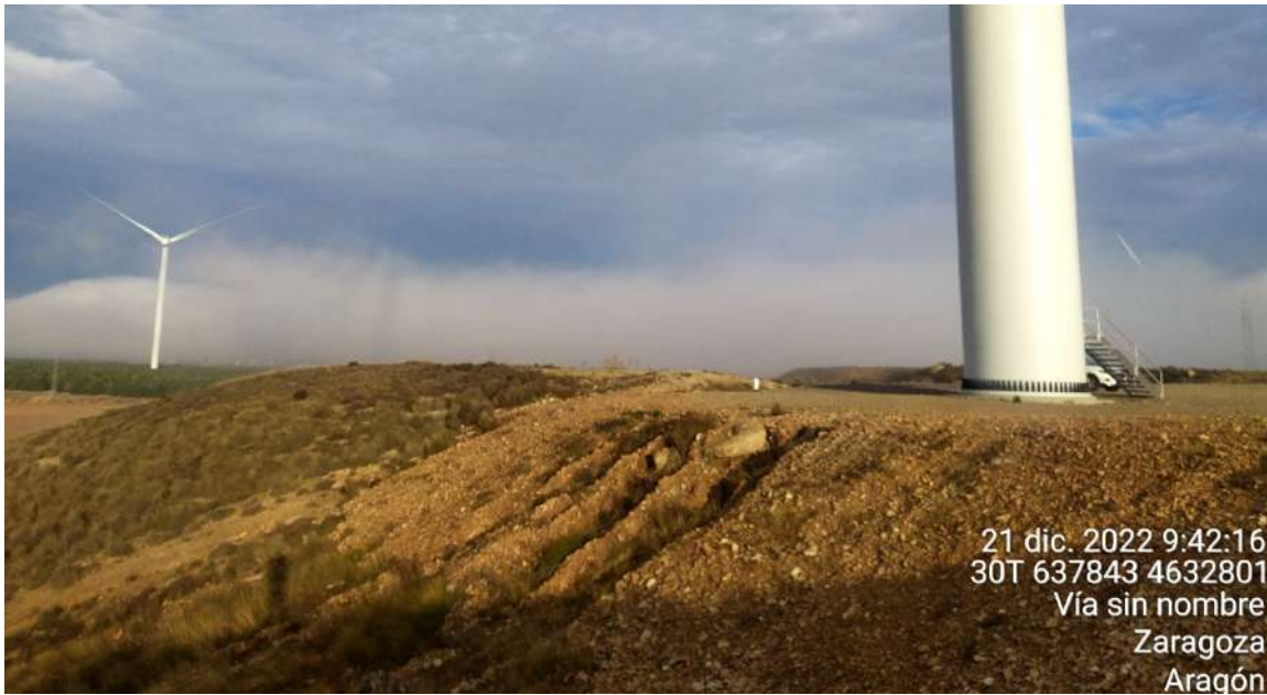
Figura 28: Fotografía del plano general de la erosión del talud al sur de la plataforma del aerogenerador MU-09.
