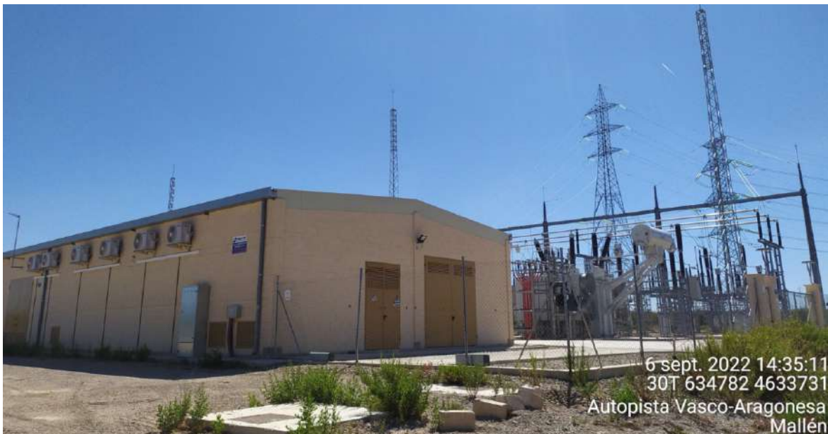
Figura 36: Subestación eléctrica Valcardera, SET asociada a PE “Multitecnología” en la que se realiza la gestión de residuos del PE, así como la ubicación del arcón refrigerador para la conservación de siniestros asociados al PE.
