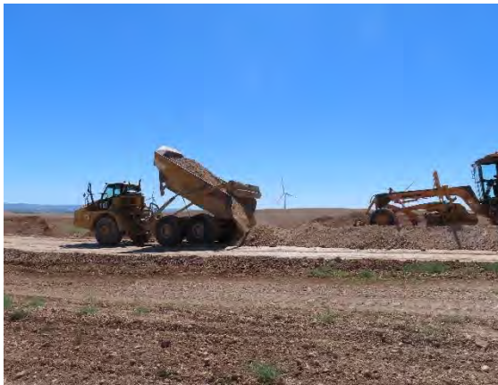
Compensación de tierras. Relleno en viales con tierras de excavación de las cimentaciones.
