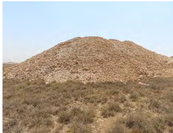
Balizado de vegetación natural no respetado con el acopio de tierras
