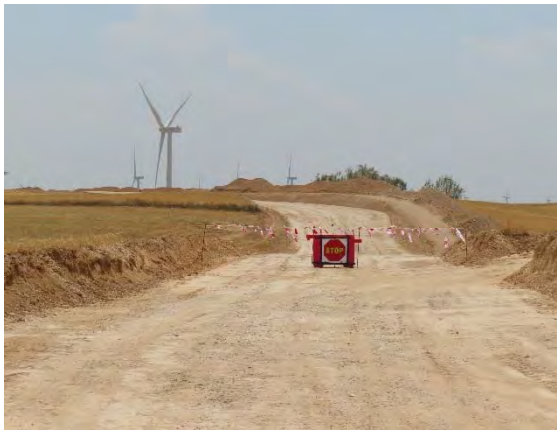
Prohibición temporal de acceso a REIIA-03 por fauna esteparia
