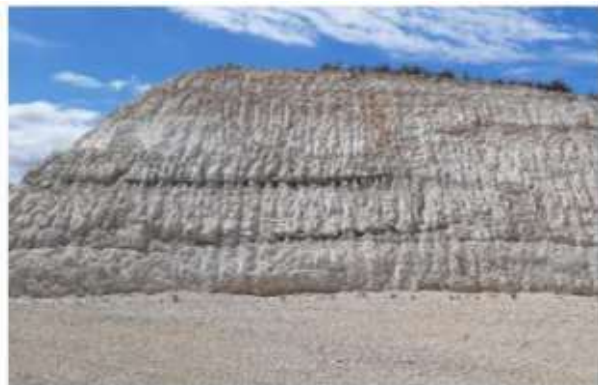
Fig. 4 Erosión hídrica en materiales margo-calizos del talud de desmonte de plataforma del aereo PO2.2.4. Fuente: Elaboración propia
