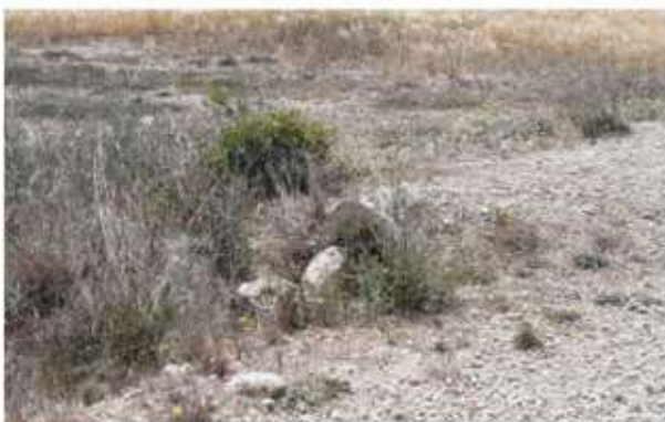
Fig. 3 Tubo de drenaje semitaponado con vegetación arbustiva y piedras en vial de acceso al aero PO2.1.11. Fuente: Elaboración propia
