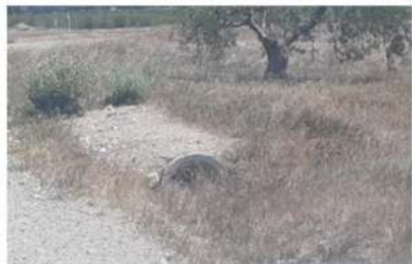
Fig. 4 Tubo de drenaje semitaponado con vegetación arbustiva en vial de acceso al aero PO2.1.1. Fuente: Elaboración propia
