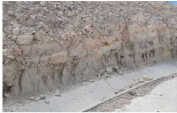
Fig. 2 Erosión hídrica en materiales margosos del talud de desmonte del vial de acceso al aéro PO2.1.6 Fuente: Elaboración propia
