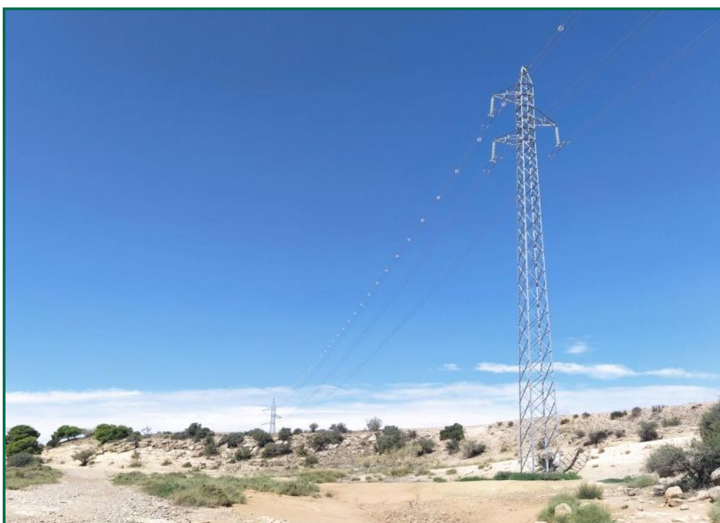
Fotografía 9. Línea eléctrica con balizas salvapájaros
