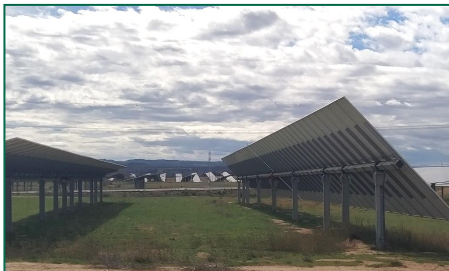
Fotografía 1. Vegetación entre placas actualmente.
