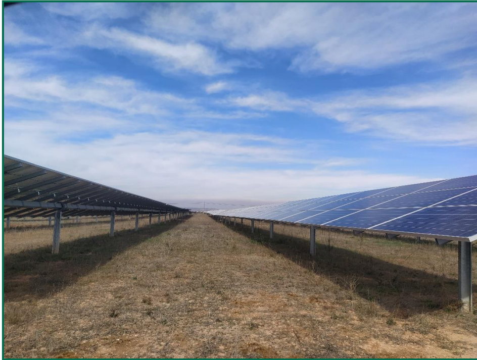
Fotografía 1. Vegetación entre placas en su estado actual.
