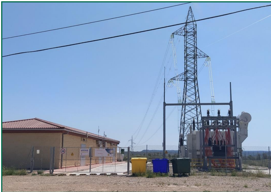
Fotografía 5. Contenedores para residuos en la SET.
