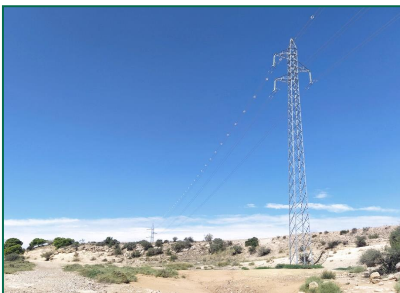
Fotografía 2. Línea eléctrica con balizas salvapájaros
