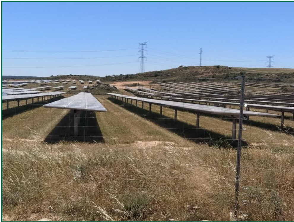
Fotografía 2. Vegetación entre placas actualmente.
