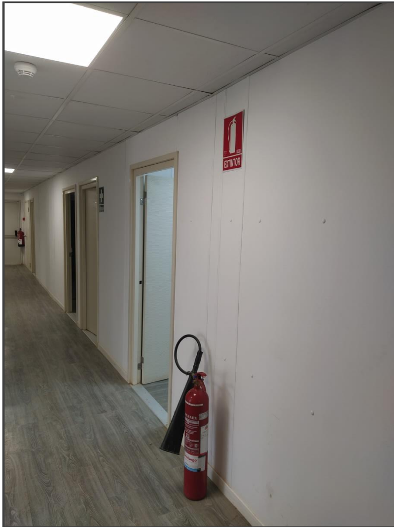
Fotografía 11. Extintores en edificio de control.
