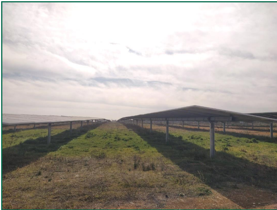
Fotografía 1. Vegetación entre placas en su estado actual.
