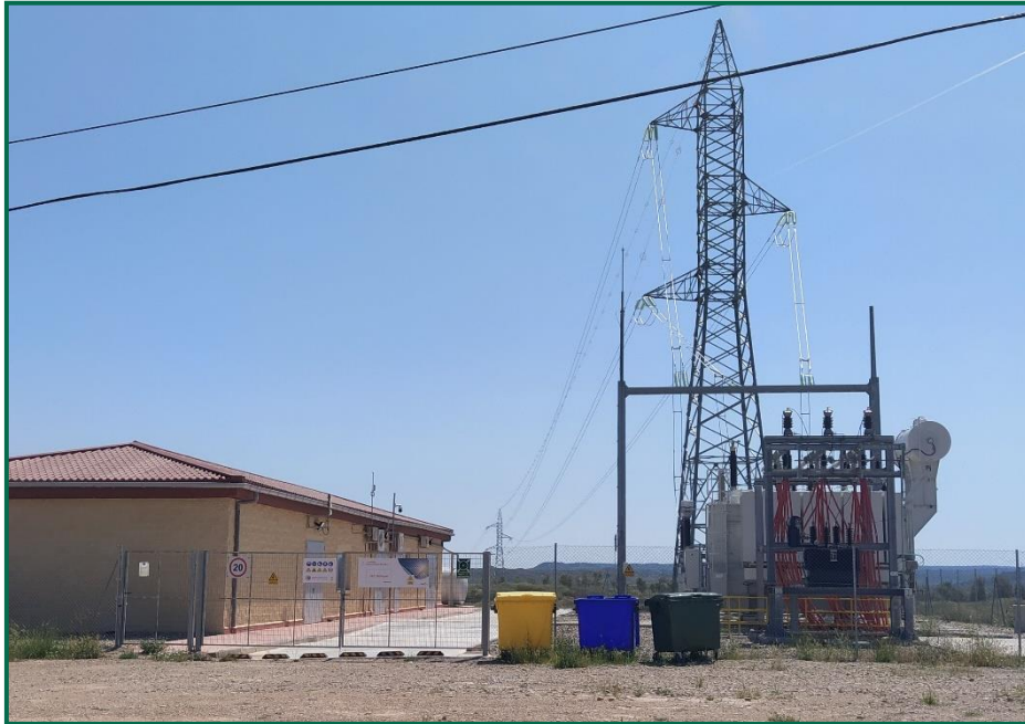
Fotografía 5. Contenedores para residuos en la SET.
