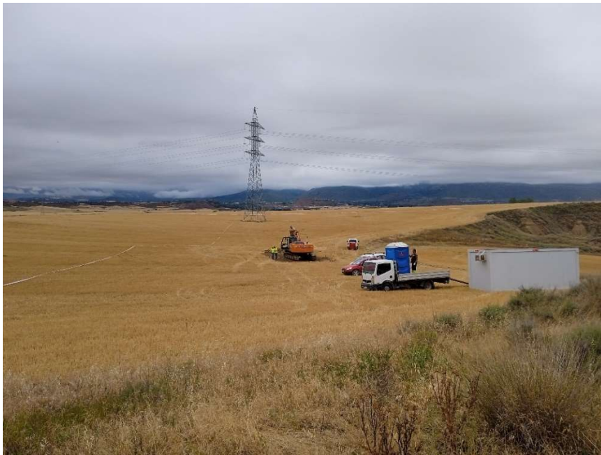
Imagen 1. Zona de acceso a la PFV por el este. Primeras descargas de baños químicos y casetas de obra
