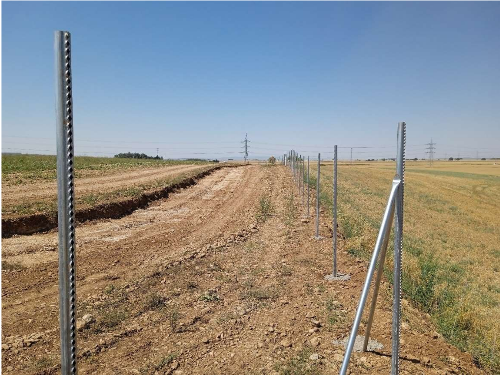
Imagen 5. Postes del vallado perimetral colocados y vial perimetral en construcción, sin la capa de tierra vegetal.
