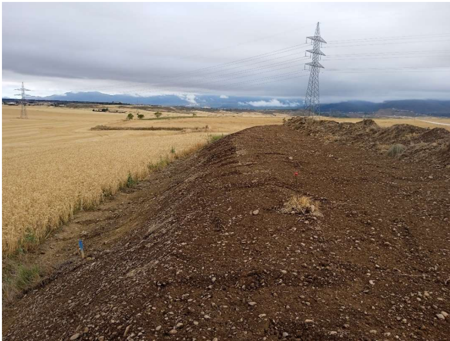
Imagen 7.- Primeros trabajos de retirada de tierra vegetal en el perímetro sur de la parcela, con el jalonado de vallado y vial perimetral.
