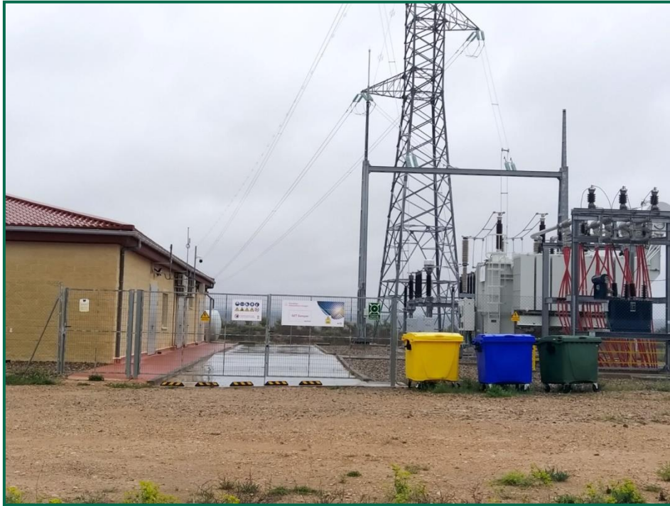
Fotografía 7. Contenedores para residuos en la SET.
