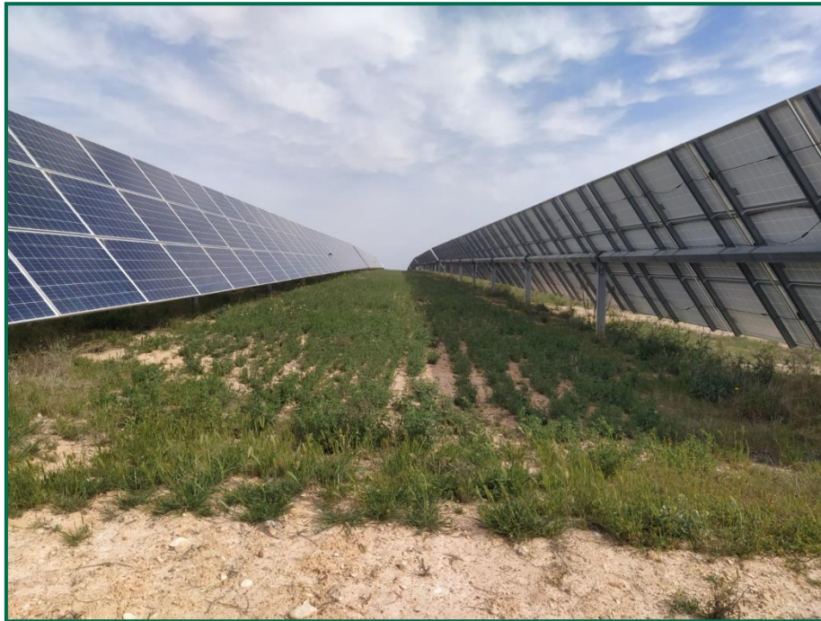
Fotografía 1. Vegetación entre placas en su estado actual.
