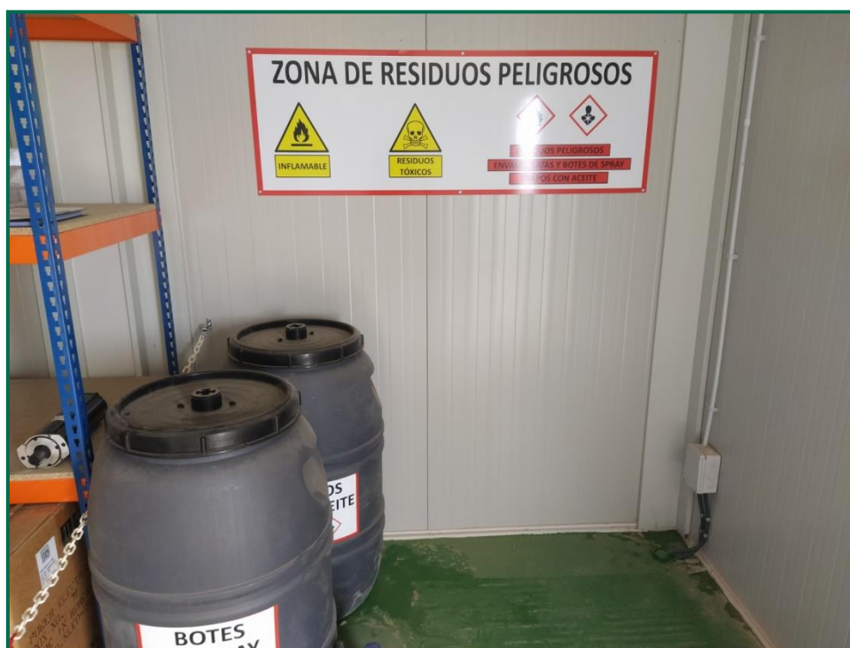
Fotografía 6. Bidones para residuos en el centro de control.
