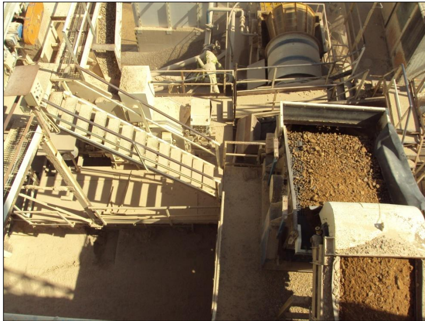
Vista parcial de las instalaciones de tratamiento.
