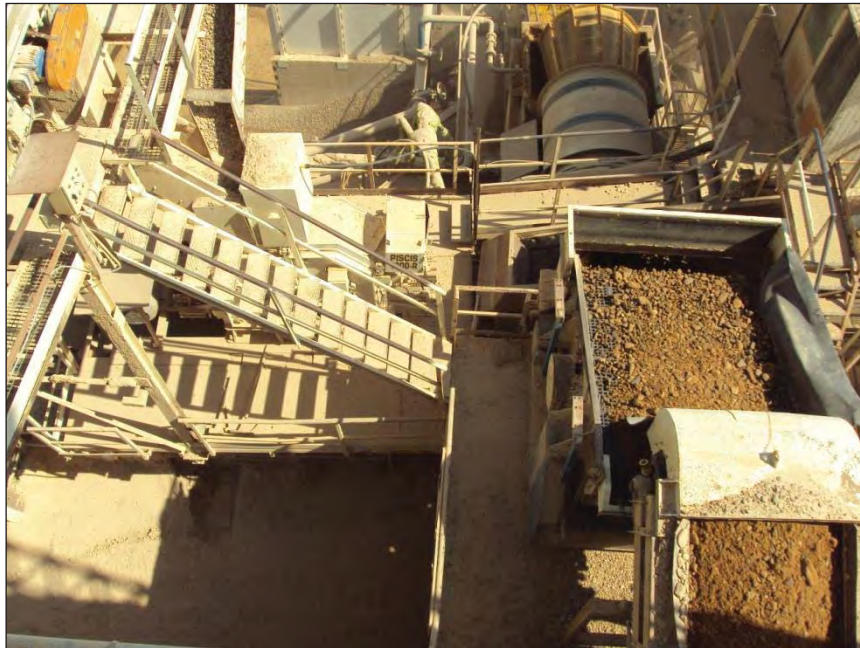
Vista parcial de las instalaciones de tratamiento.
