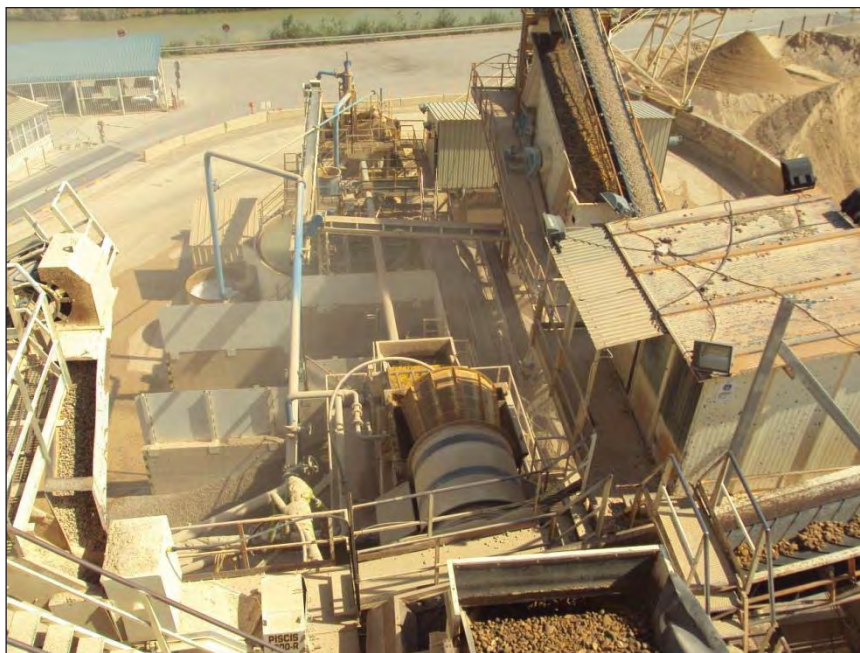
Vista parcial de las instalaciones de tratamiento.
