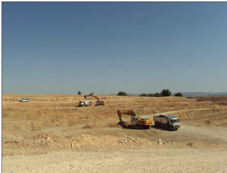
Fotografía 1.- Vista de la operación. Se observa lo indicado en la memoria. Bancos de operación de 3,5 metros para llegar a los bancos finales de 15 metros, con bermas de anchura mínima de 6 metros.
