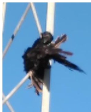
Fotos 15. Choque contra tendidos eléctricos.
