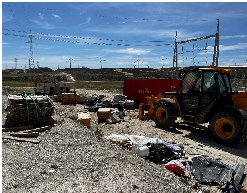
Figura 2 Restos de material de construcción
