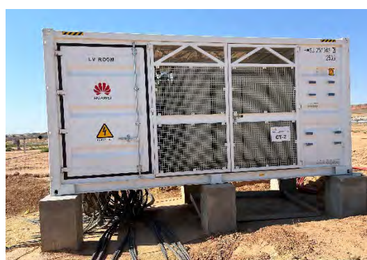
Figura 12 Cableado de los centros de transformación
