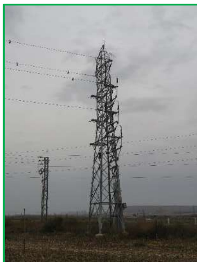
Figura 12: Vista del apoyo 16 de la LAAT.
