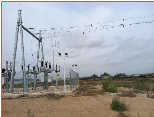
Figura 2: Salida de la línea de la SET PFV Poleñino (31/10/2022)
