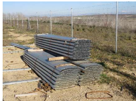
Figura 29: Acumulación de material de obra entorno la SET
