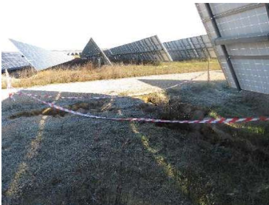
Figura 19: Socavón en la zona de la media tensión (MT).
