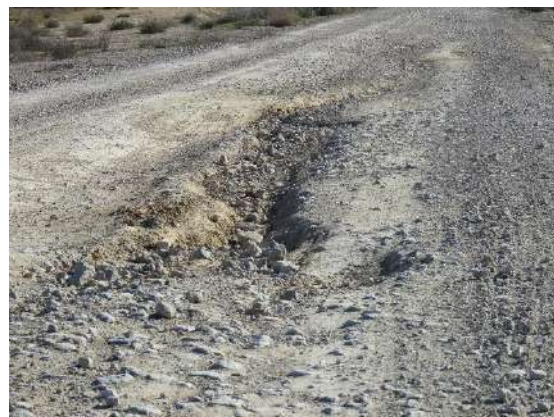
Figura 25: Cárcava en el camino de acceso a la planta por mal drenaje
