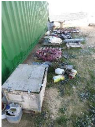
Figura 28 : Acumulación de residuos entorno la SET
