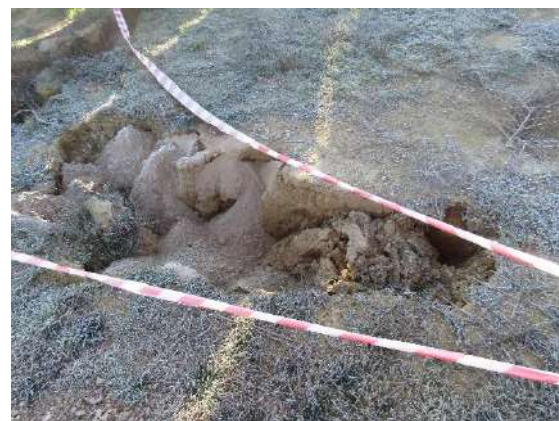
Figura 20: Detalle del socavón en la zona de MT.
