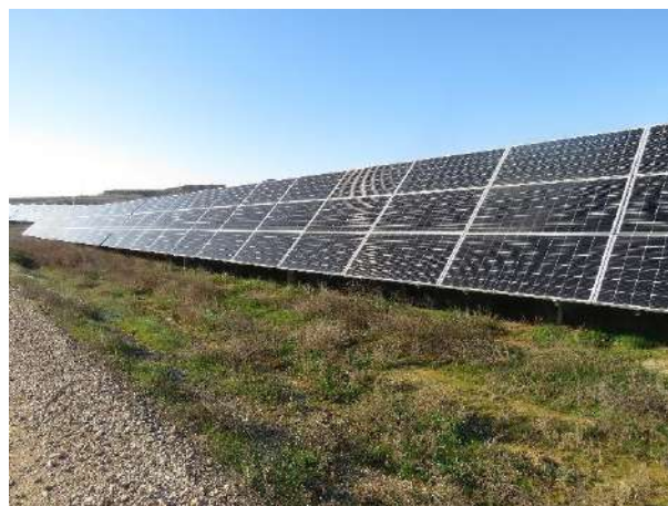
Figura 5: Trackers de la planta fotovoltaica. Fecha: 30/01/2023.
