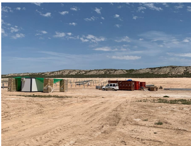
Figura 3 Punto limpio de RNP y zona de sombra
