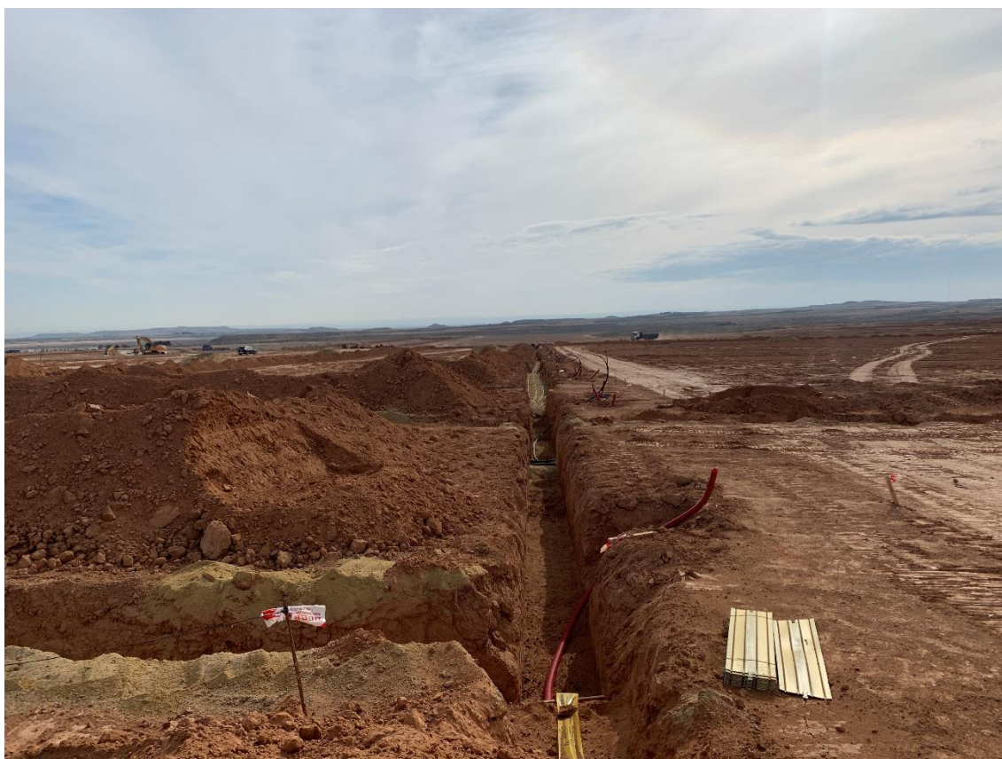
Figura 2 Cableado de la RMT
