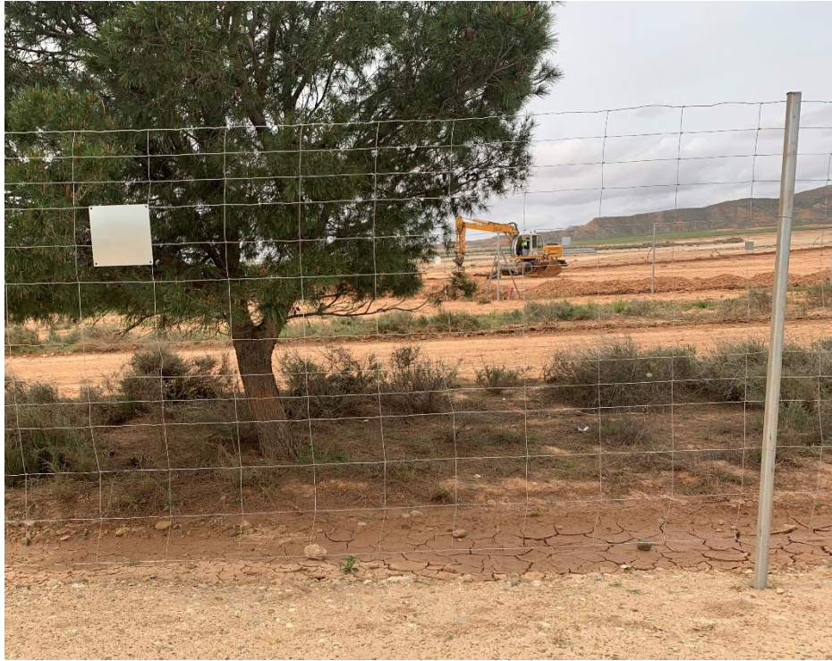
Figura 10 Vallado perimetral de la zona de casetas subsanado
