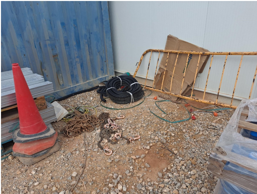
Foto 9. Falta de orden y limpieza
