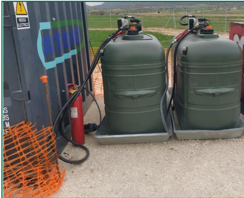
Fotografía 16. Extintor junto a contenedores de combustible.
