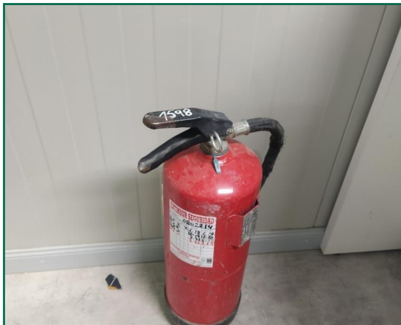
Fotografía 17. Extintor en el interior de las oficinas.
