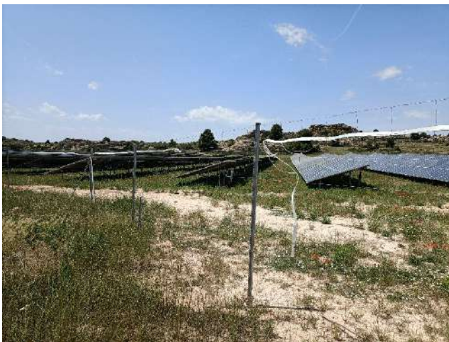
Figura 53. Inspección del fleje (zona de rotura)
