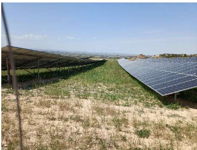
Figura 3. Entre seguidores solares (18-05-2022)
