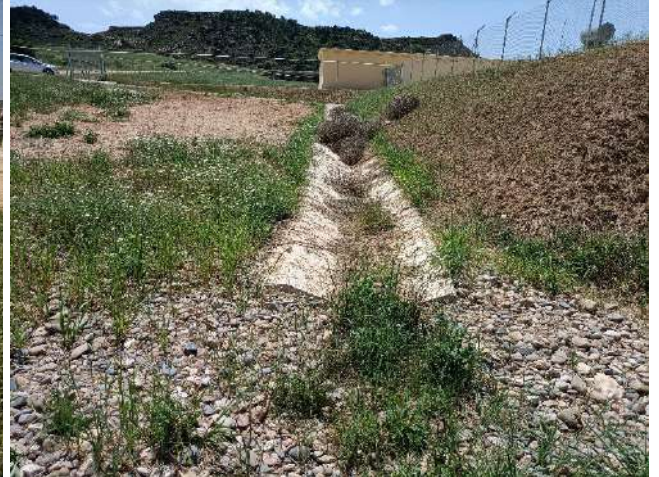
Figura 14: Cuneta interior de pluviales (zona SET)
