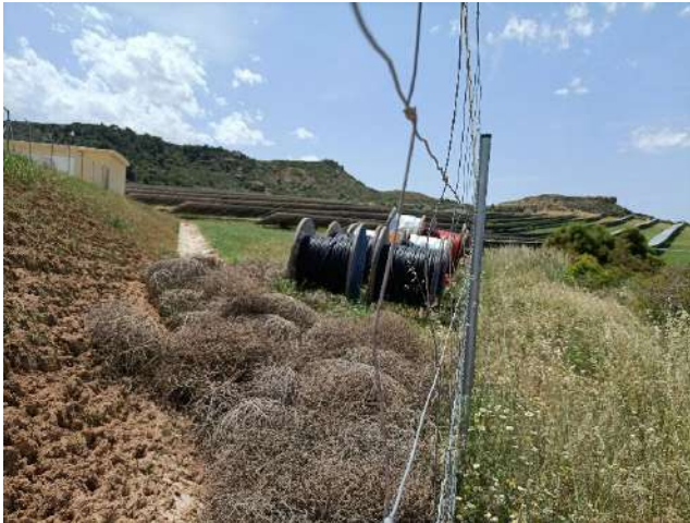
Figura 51. Acumulación vegetación rodante en cuneta y vallado
