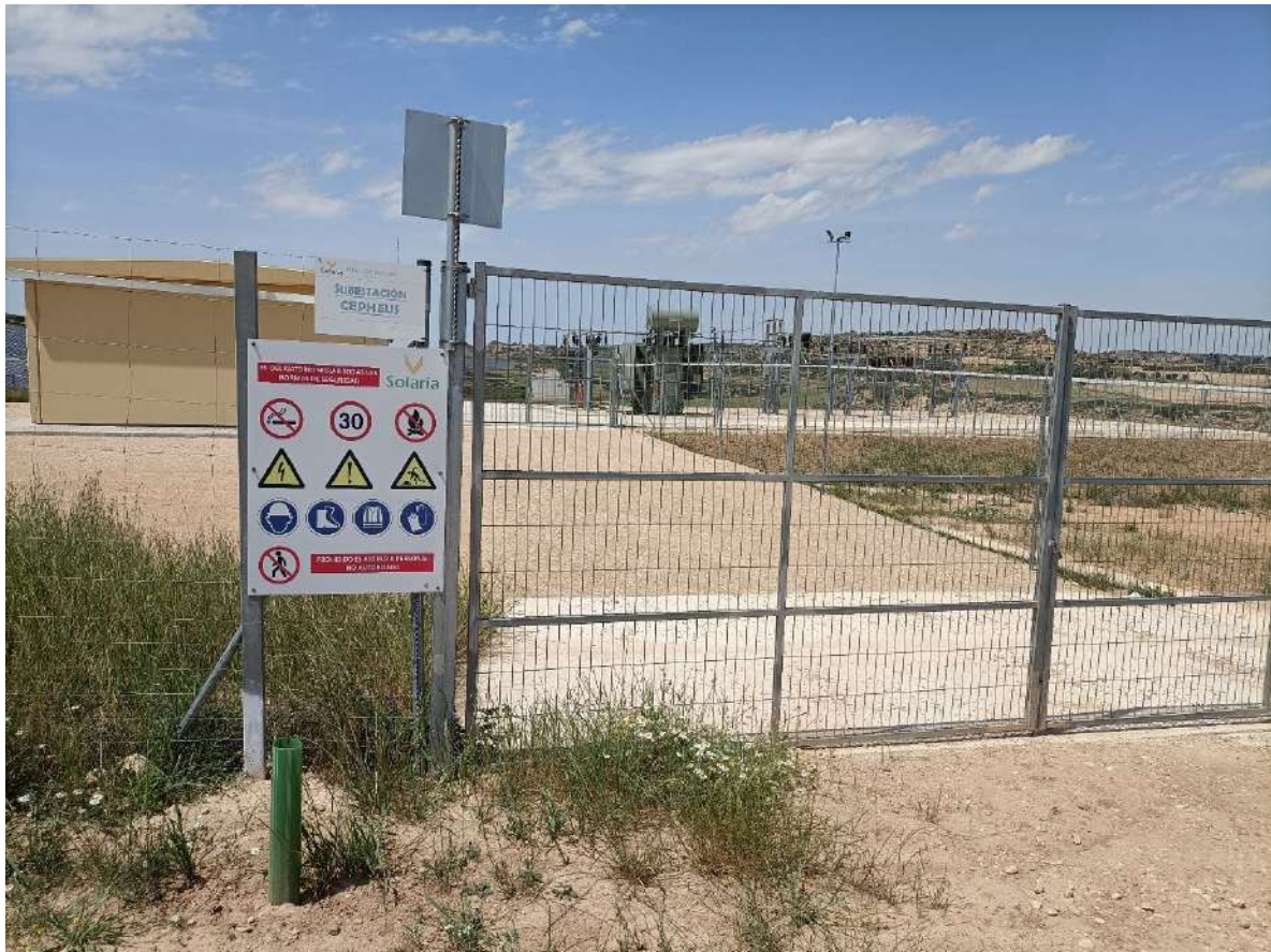
Figura 31. Puerta de Subestación Cepheus (18-05-22)
