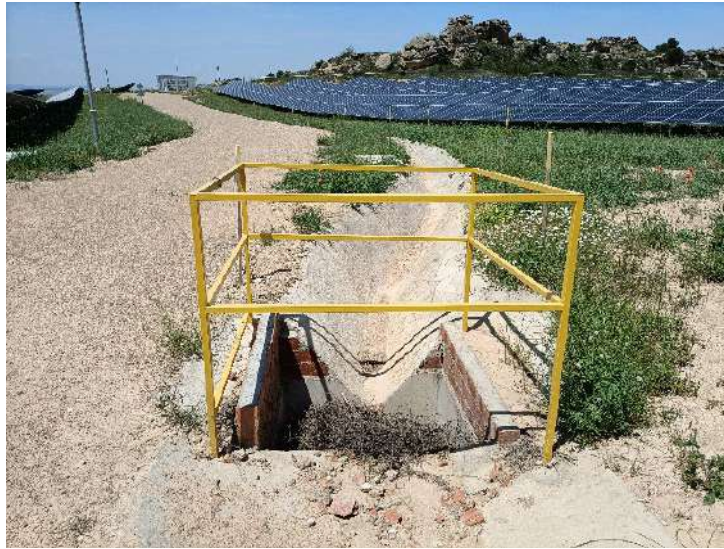
Figura 55. Vial interior y cuneta de recogida de aguas pluviales en buen estado
