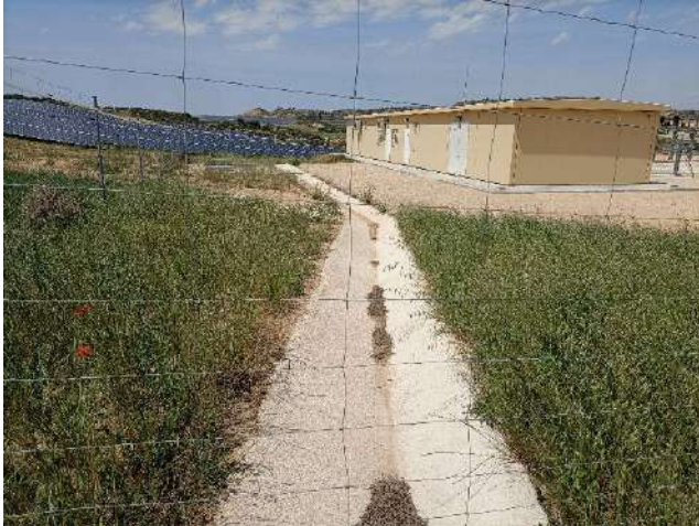
Figura 13 : Cuneta interior de pluviales (zona SET)
