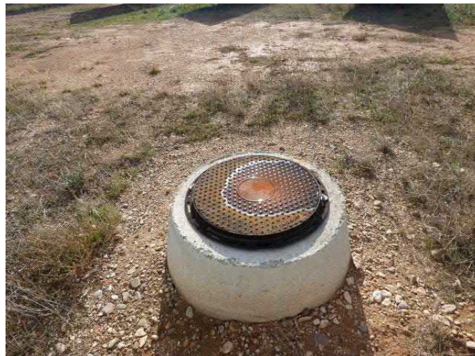
Imágenes 1, 2 y 3 : Depósito de agua limpia, vista externa e interna (imágenes superiores). Depósito estanco (foto exterior)
