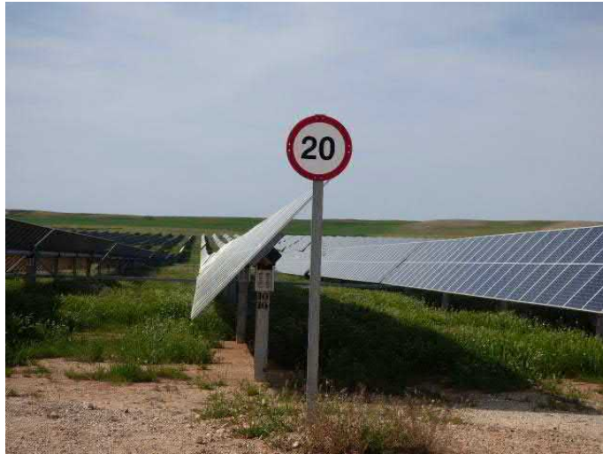
Imagen 16: Señal de límite de velocidad situada en uno de los viales del parque fotovoltaico.
