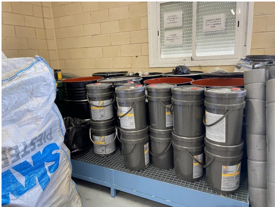
Figura 11: Interior del almacén de residuos de la SET “Tinajeros”, con los diferentes residuos peligrosos clasificados, aislados de la intemperie y sobre una tarima aislante para evitar posibles filtraciones al suelo.
