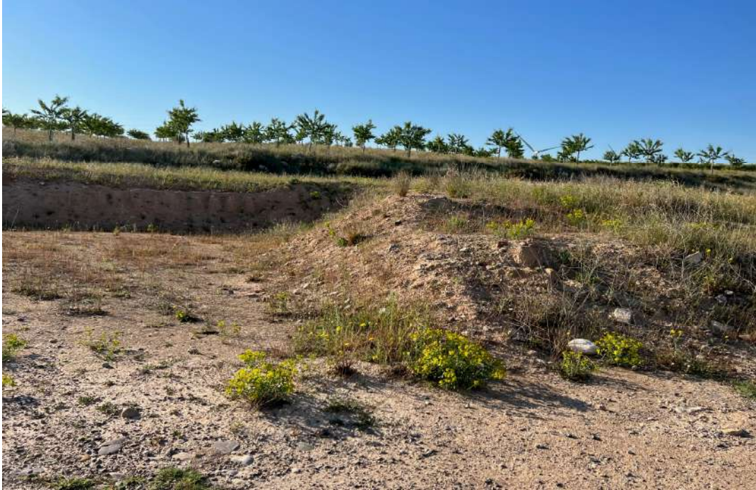
Imagen 14. Estado del talud anexo a la plataforma aerogenerador 4.
