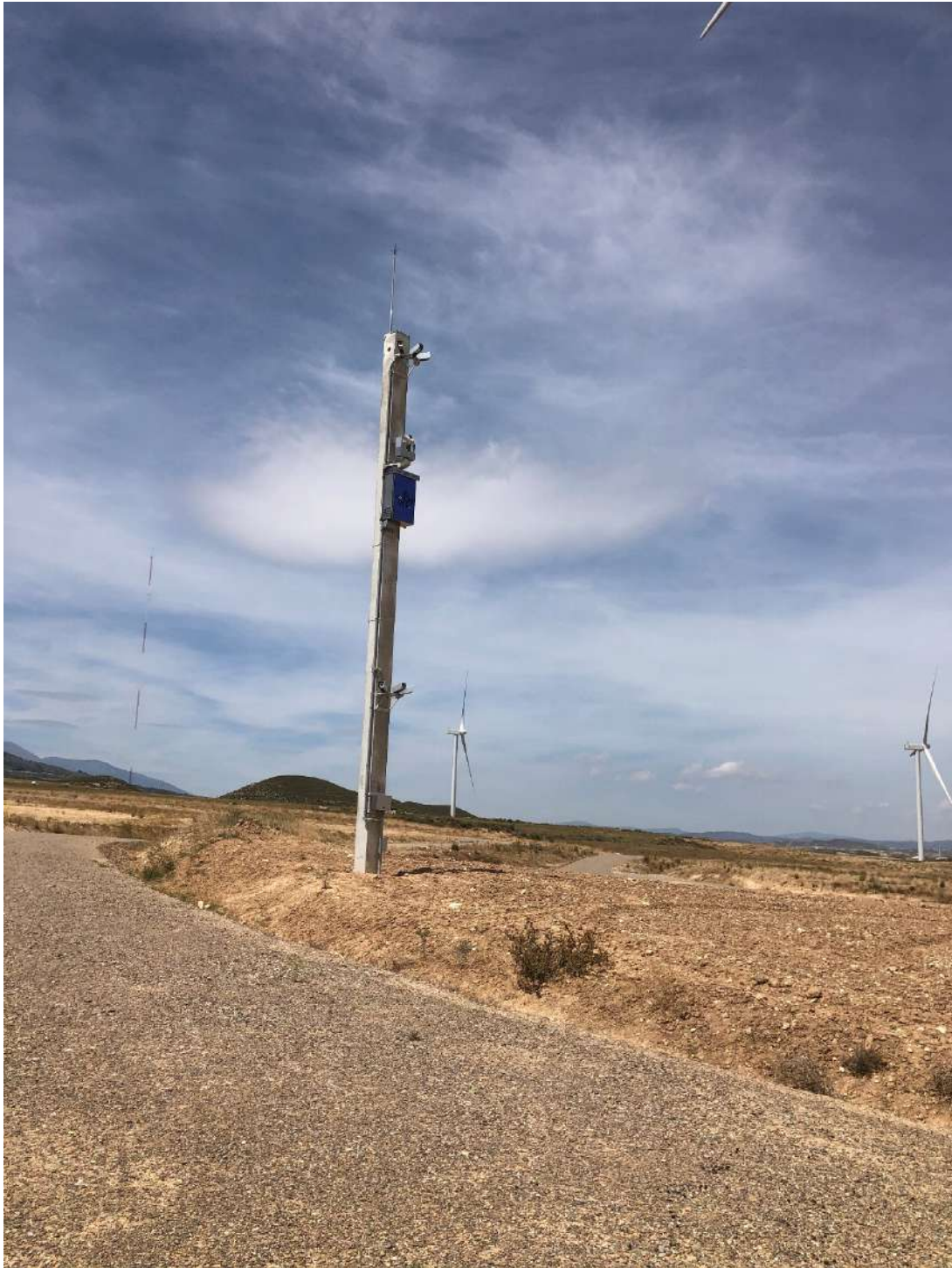
Imagen 7. Vista del 3dobsever 2 ya instalado.
