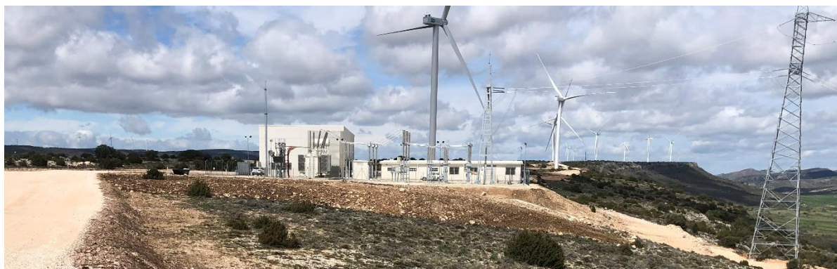
Figura 2: Vistas de la subestación Oriche
