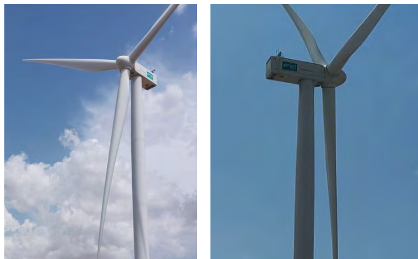
Fotografías 3 y 4: Barquillas de los aerogeneradores sin derrames de aceite
