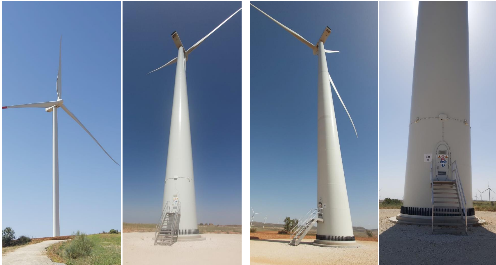
Fotografías 1 a 4: Estado de los aerogeneradores.
