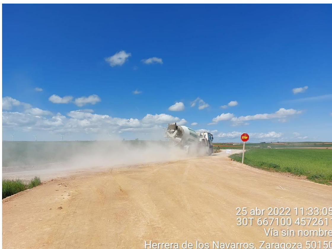
Imagen 1. Polvo generado por camiones durante su camino al hormigonado.
