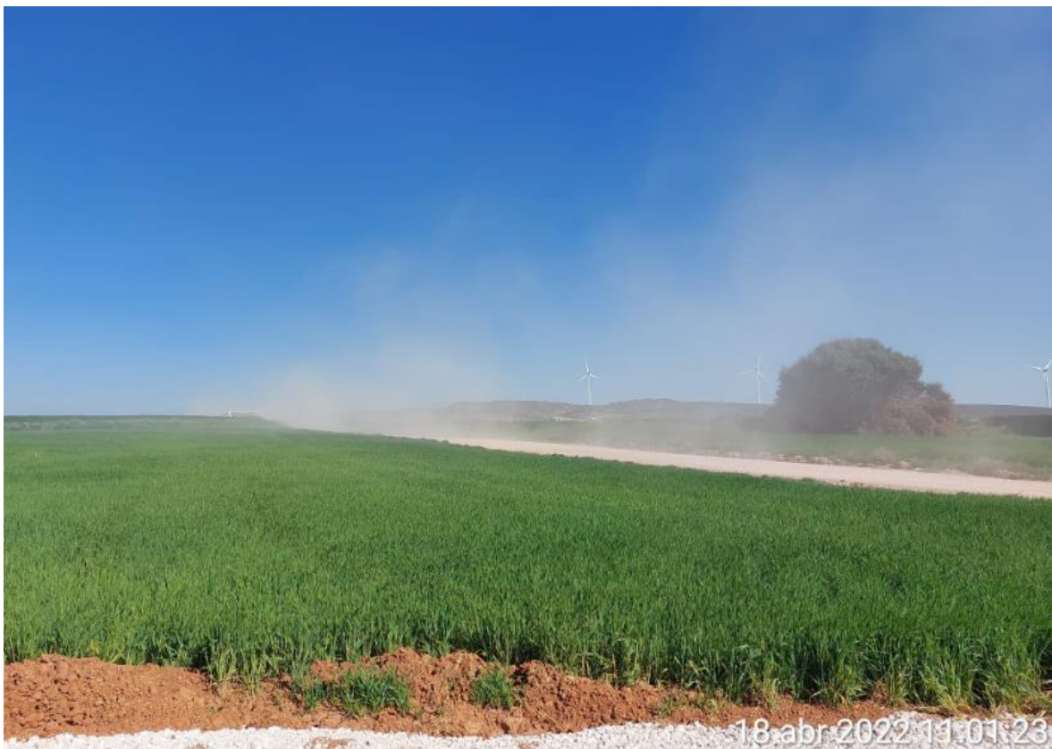
Imagen 2. Polvo generado debido al tránsito de camiones.
