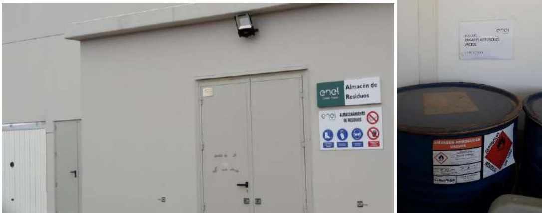
Punto limpio habilitado en la subestación Ventavieja para los parques eólicos de Muniesa, San Pedro de Alacón y Farlán
