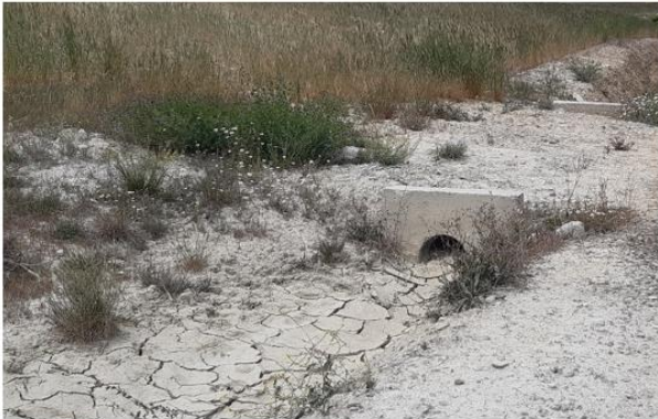
Fig. 5 Tubo de drenaje semitaponado con sedimentos en vial de acceso al aereo ML4.02. Fuente: Elaboración propia
