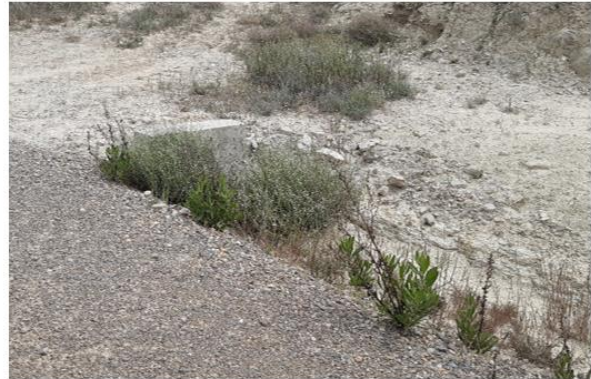
Fig. 6 Tubo de drenaje taponado por vegetación arbustiva y sedimentos en vial de acceso al aereo ML4.05. Fuente: Elaboración propia
