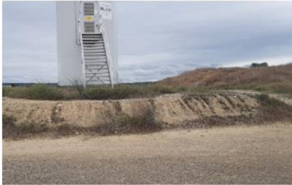
Fig. 1 Erosión hídrica en materiales margo-arenosos de la cimentación de ML2.03.
