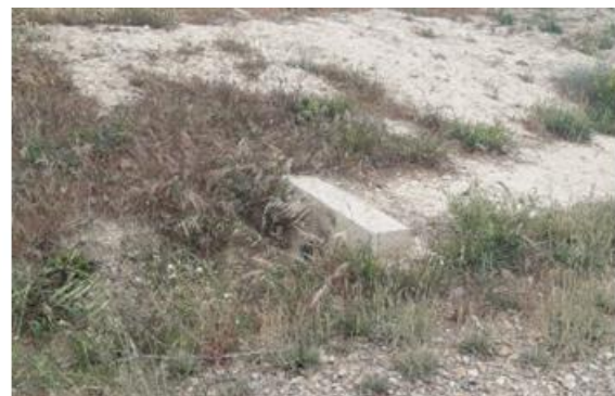
Fig. 2 Tubo de drenaje semitaponado con vegetación arbustiva en vial de acceso al aero ML2.08.
