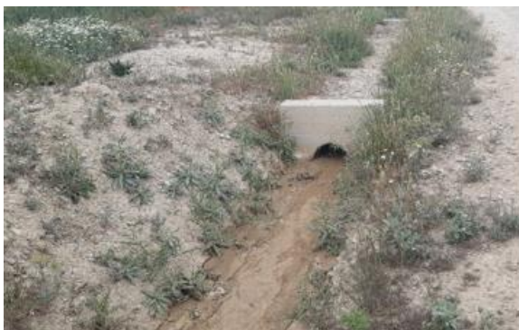
Fig. 1 Tubo de drenaje semitaponado con sedimentos en vial de acceso al aero ML2.08.
