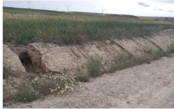
Fig. 2 Erosión hídrica en materiales margo-lutíticos del talud de desmonte del vial de acceso a ML2.08.
