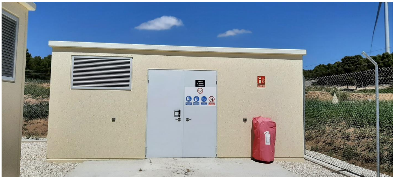
Punto limpio habilitado en la subestación Cañaseca para el parque eólico “Los Gigantes”
