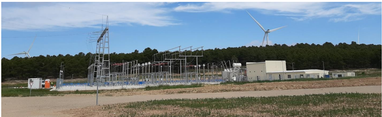
Figura 1: Vistas de la subestación Cañaseca.
