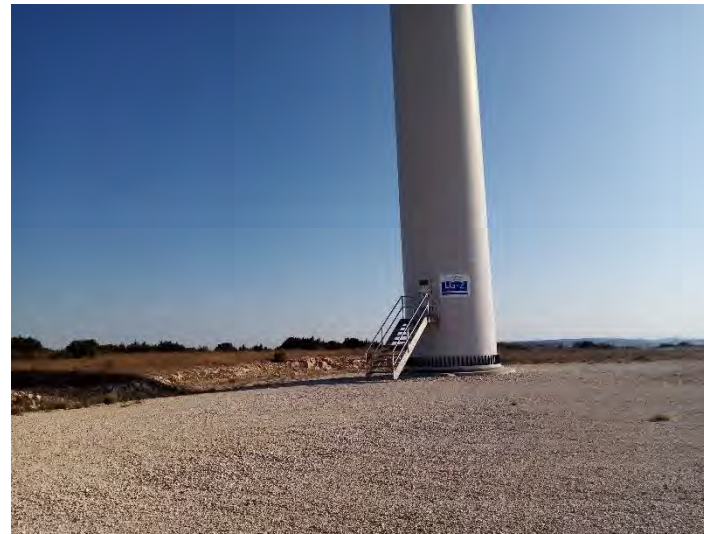
Fotografías 3 a 5: Estado de los caminos y viales
