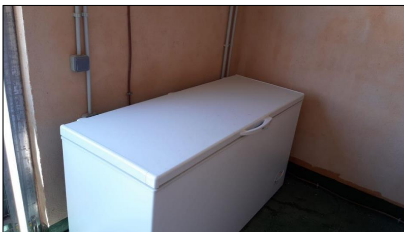
Fotografía 1. Arcón congelador del parque eólico
