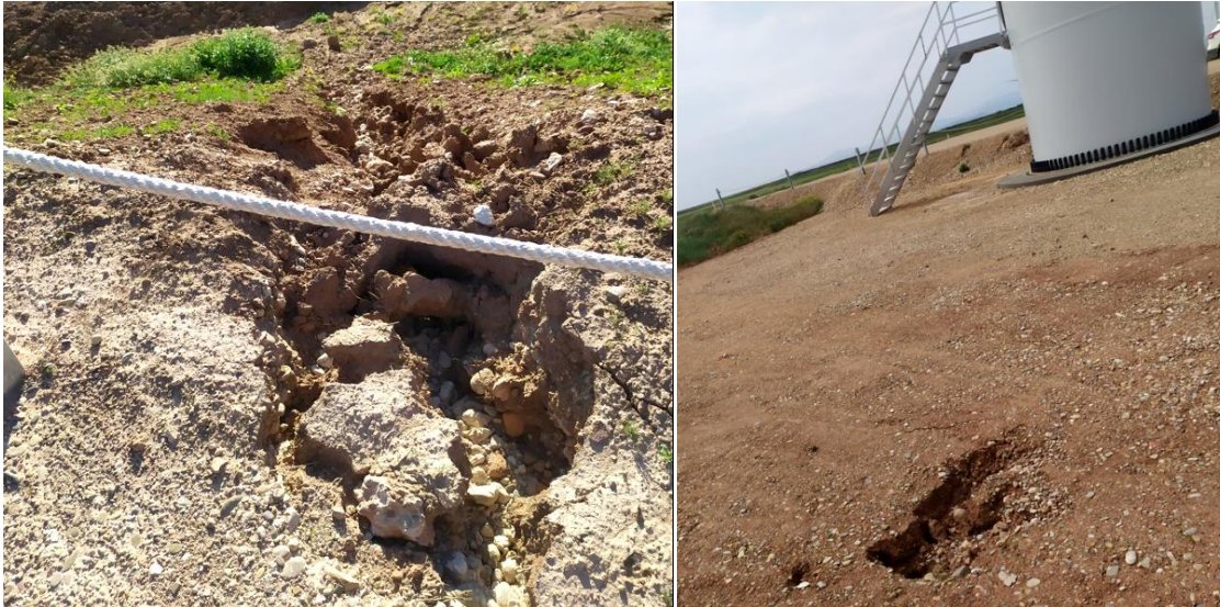
Figura 29: Fotografía izquierda: Cárcava en talud de plataforma del aerogenerador ET12. Fotografía derecha: Erosión parcial del suelo en una pequeña sección de la plataforma del ET9.
