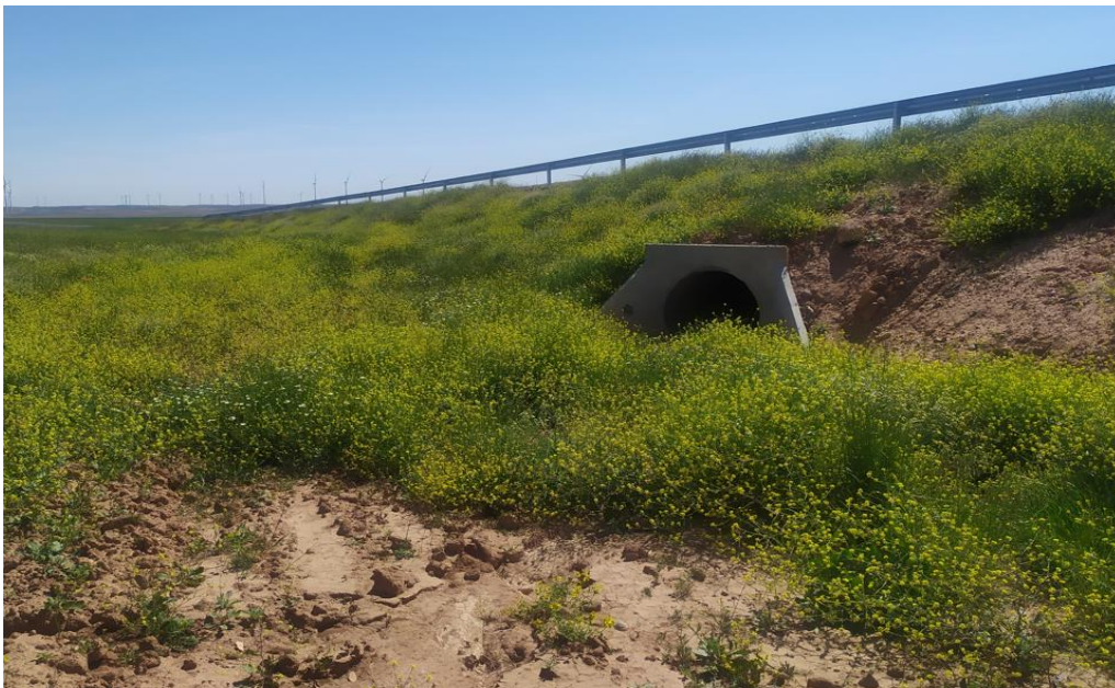
Figura 28: Desagüe situado en vial próximo a aerogeneradores ET8 y ET9 en buen estado.
