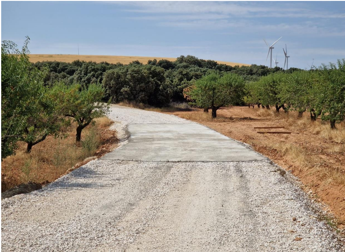
Imagen 2. Badén entre SB2-05 y SB2-06.
