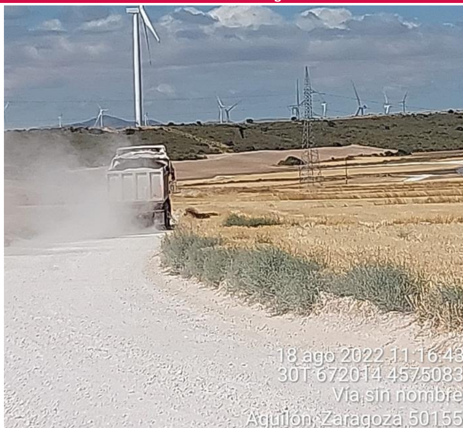
Imagen 1. Bañera sin lona de protección en vial de la obra.
