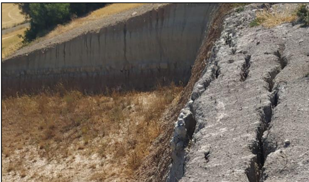
Fotografía 4. Pequeño reguero en el talud del aerogenerador LP-09.
