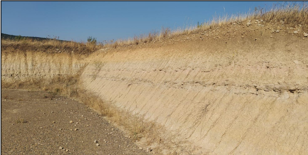
Fotografía 3. Desmonte desprovisto de vegetación.
