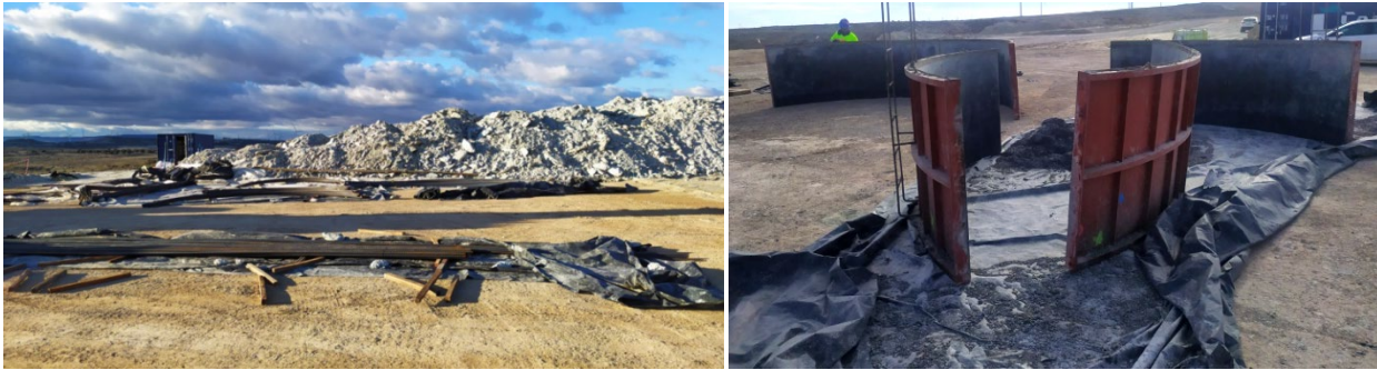
Foto 14. Lonas de plástico colocadas bajo diferentes piezas empleadas en el ferrallado y el hormigonado de la obra, con el fin de evitar la contaminación del suelo.
