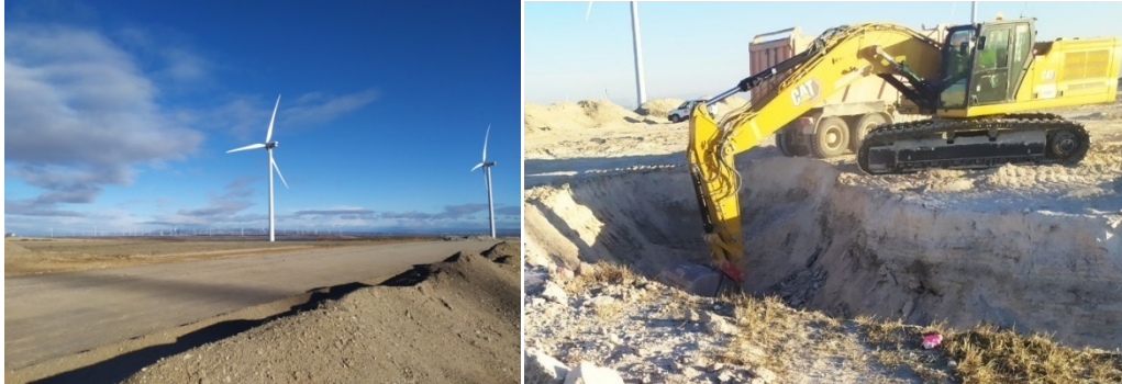
Foto 20. Plataforma 3 terminada ya durante la segunda visita de revisión ambiental, y comienzo de excavación del foso de la cimentación 3 (18/11/2022).
