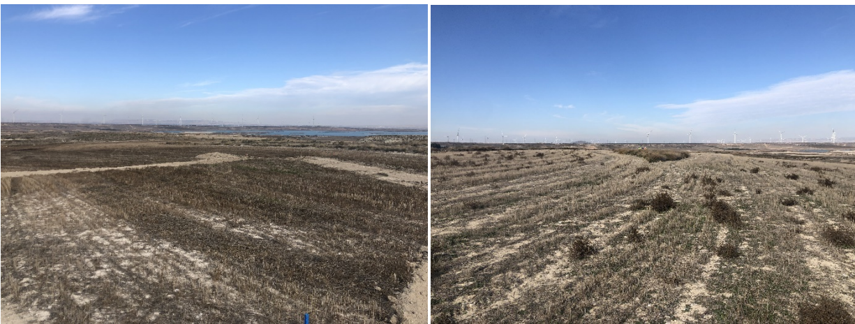
Foto 16. Estaquillado de las posiciones de los futuros viales y plataformas del parque (4/11/2021).
