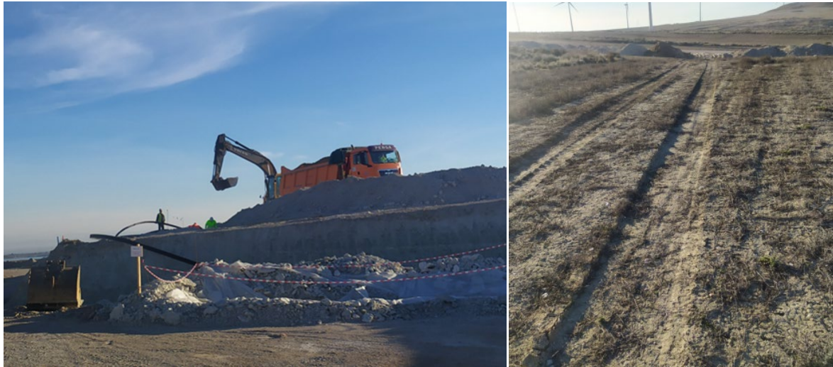
Foto 7. Fotografías del talud elevado que impedía el acceso a la maquinaria de obra (izquierda) y el acceso temporal (derecha) que se realizó desde el vial sur de acceso al aerogenerador 2. Fotografías del 3/2/2022.
