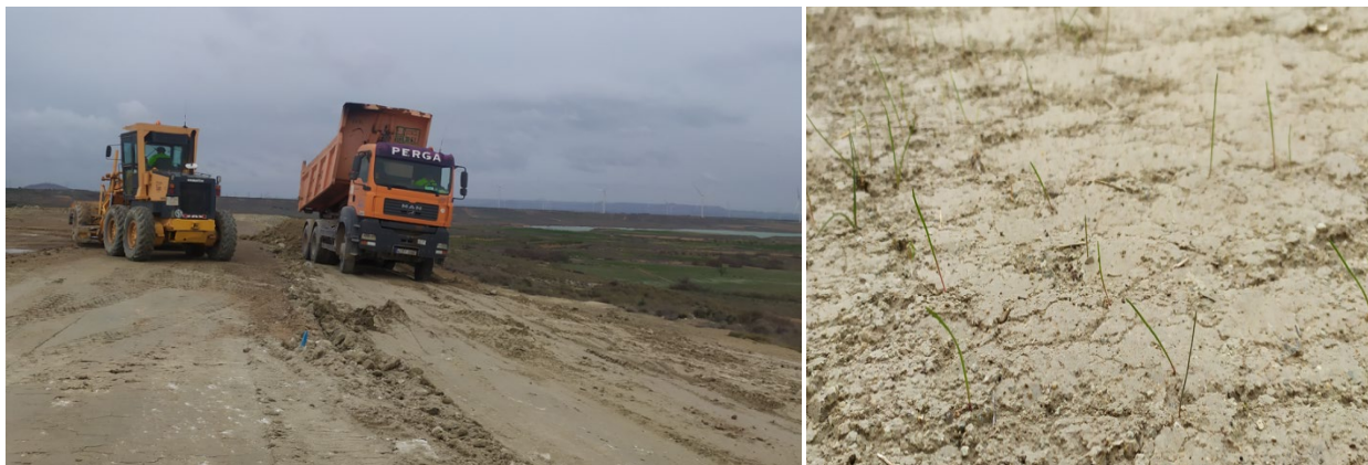
Foto 31. Camión volcando tierra vegetal sobre el talud norte de la plataforma del aerogenerador (izquierda) y primeros brotes de vegetación creciendo en la misma zona restaurada (correspondiente a una zona de cultivo).
