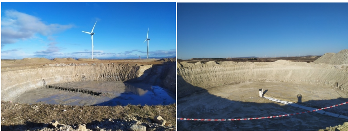
Foto 23. Distintas fases de excavación de los fosos de cimentación de los aerogeneradores.
