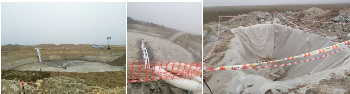
Foto 25. Fosos de aerogeneradores 3 y 2 con la capa de hormigonado de limpieza ya aplicada, y piscina de lavado de hormigón preparada (todas fotografías del 16/12/2021).
