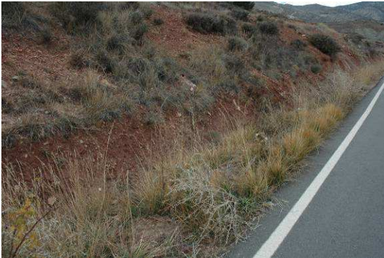
Estado de las cunetas antes de las actuaciones
