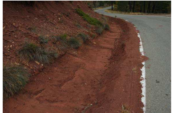
Estado de las cunetas después de las actuaciones
