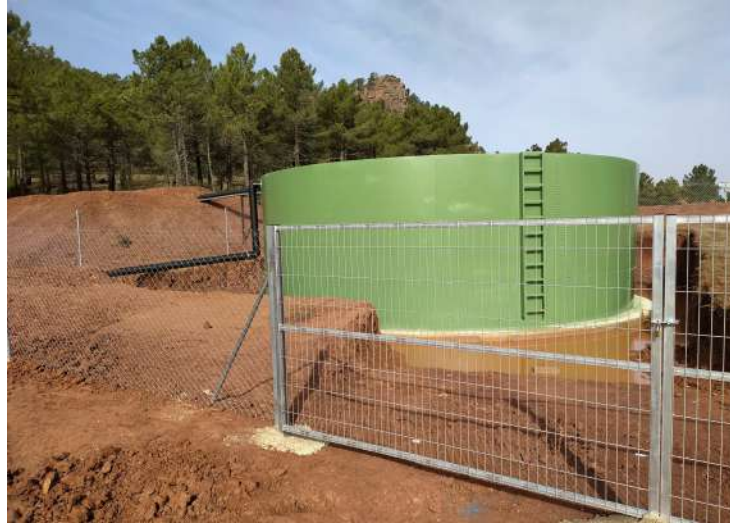
Depósito de incendios.
