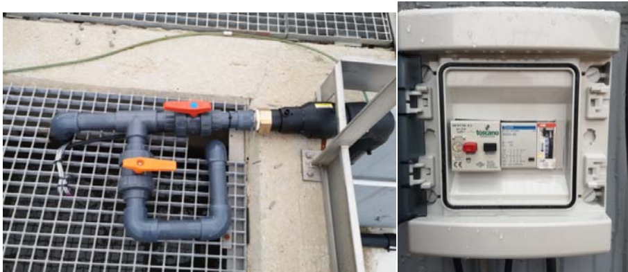
Ilustración 13. (Izq.) Sistema de toma de agua, compuesto por una bomba y un by pass para retirar el exceso de agua que nos ofrece la bomba. (Dcha.) Temporizador para controlar el caudal de entrada al sistema.
