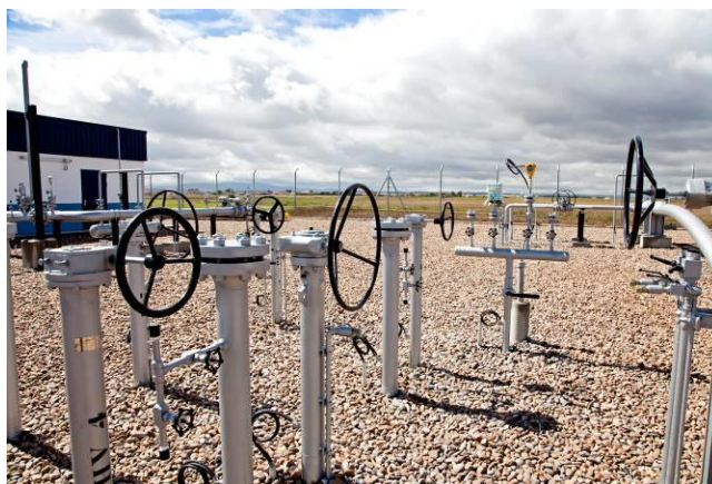
Válvulas en instalación gasista. Foto: Redexis Gas
